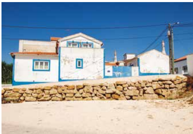
USSEIRA Muro de Suporte de Terras e Regularização para pavimentação Travessa das Hortas
